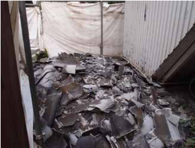
写真：屋根のスレート材が破碎されて落下している様子
