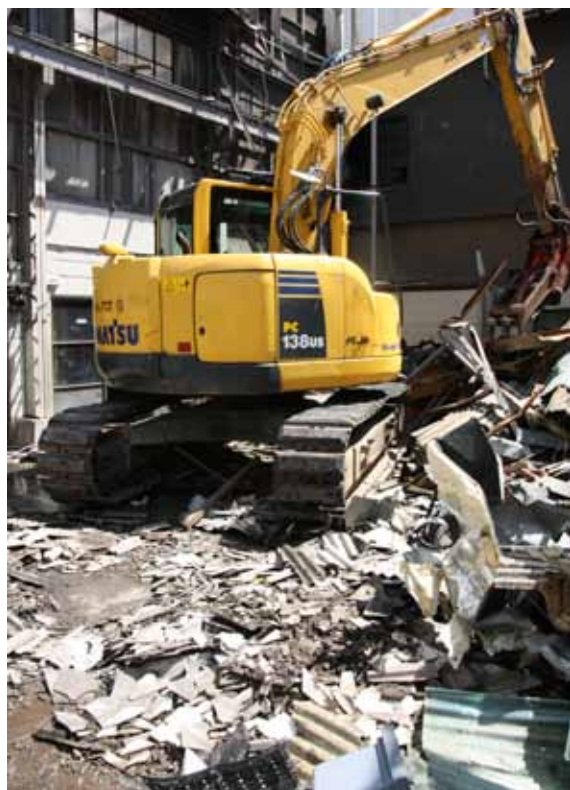
写真：東京都江東区で2009年にみられたアスベスト含有建材の違法解体
